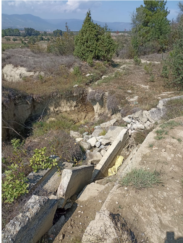
Fotoğraf 1: TR82 Bölgesi'nde Tahrip Olan Sulama Kanalları
