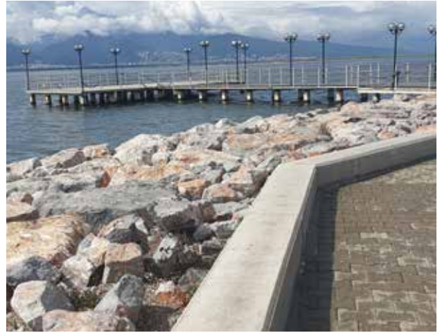
FOTOĞRAF 2.5.4. Mavişehir Mahallesi'nde deniz suyunun yükselmesi ve su baskınına önlem olarak yapılan kıyı tahkimatı ve çevre düzenlemesi (Proje saha çalışmaları arşivi, 2023)
